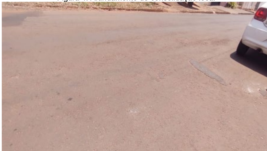
Figura 4: Afundamento de consolidação local
