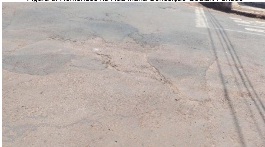
Figura 3: Remendos na Rua Maria Conceição Goulart Furtado
